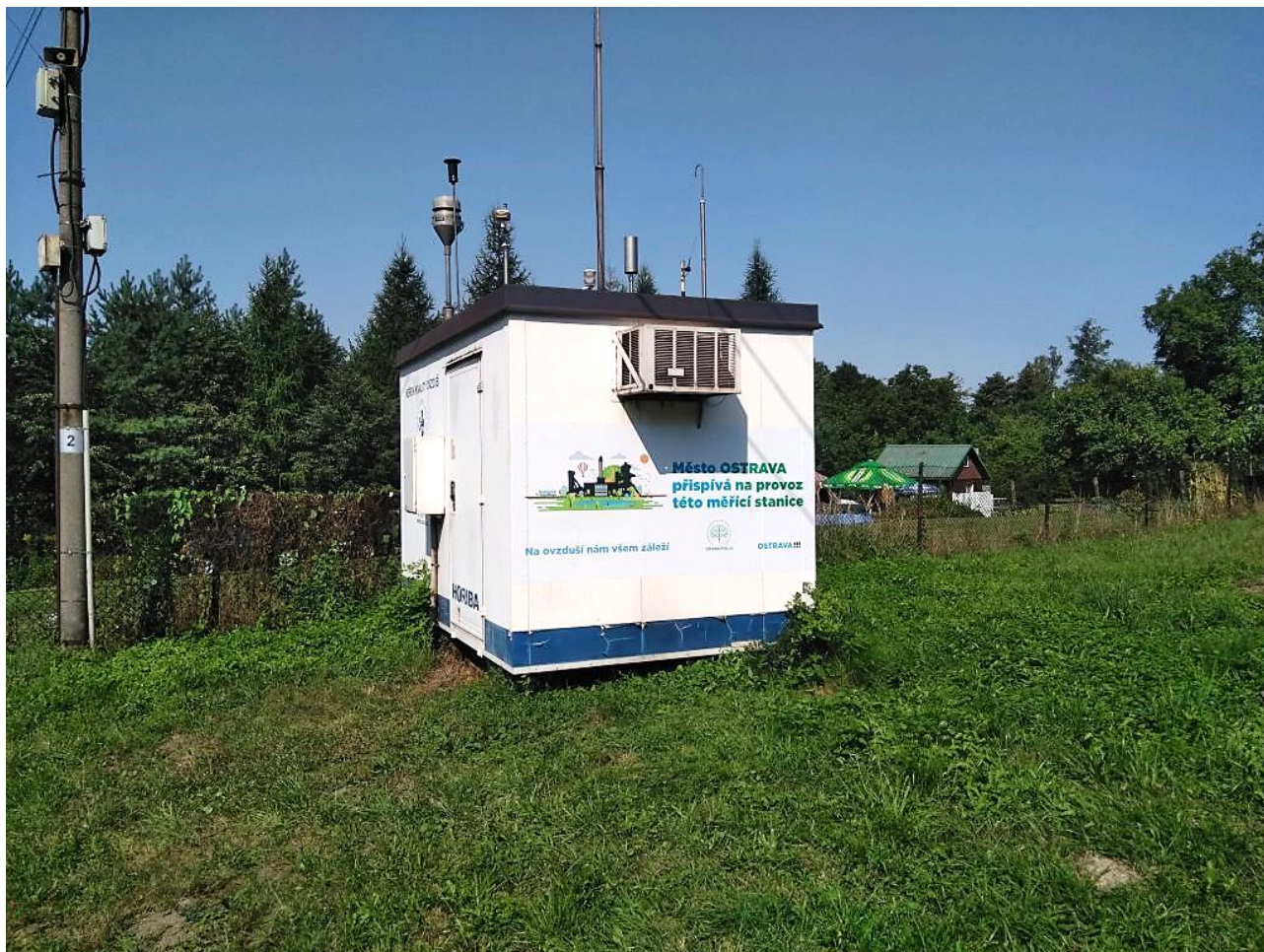
Obrázek 2: Stanice Ostrava-Radvanice ZÚ
