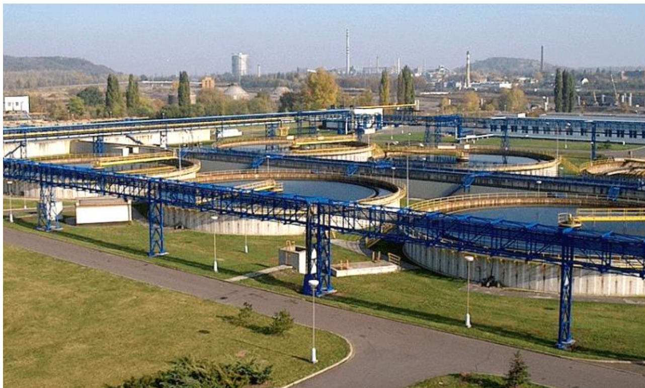
Obrázek 11: Ústřední čistírna odpadních vod
